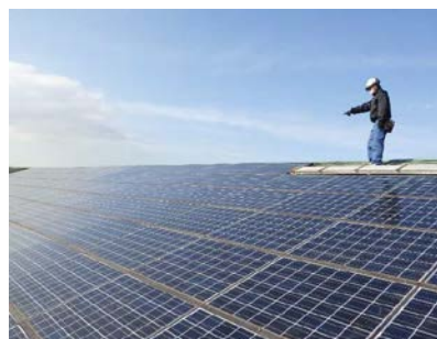
屋根 斜面部：太陽電池の設置状況(東側のパネル部分)
