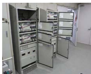
パワーコンディショナ装置の状況
