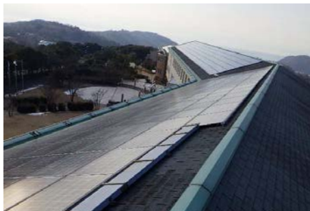
屋根 斜面部：太陽電池パネル設置状況(屋根東側から西側を見る)
