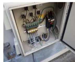
接続箱の腐食状況
